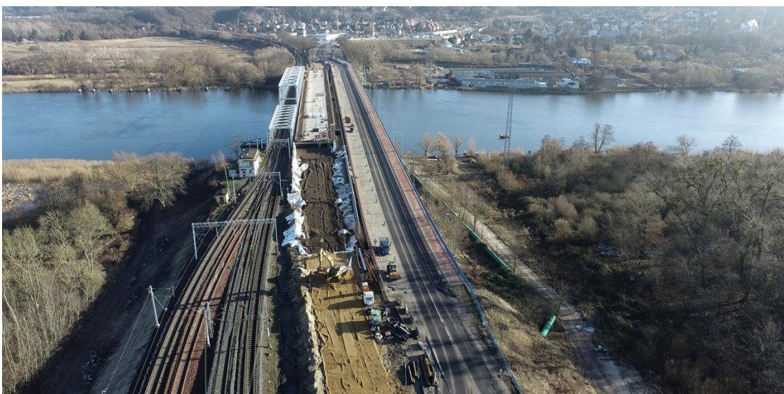
Foto 19. Cruce de Granitowa.
